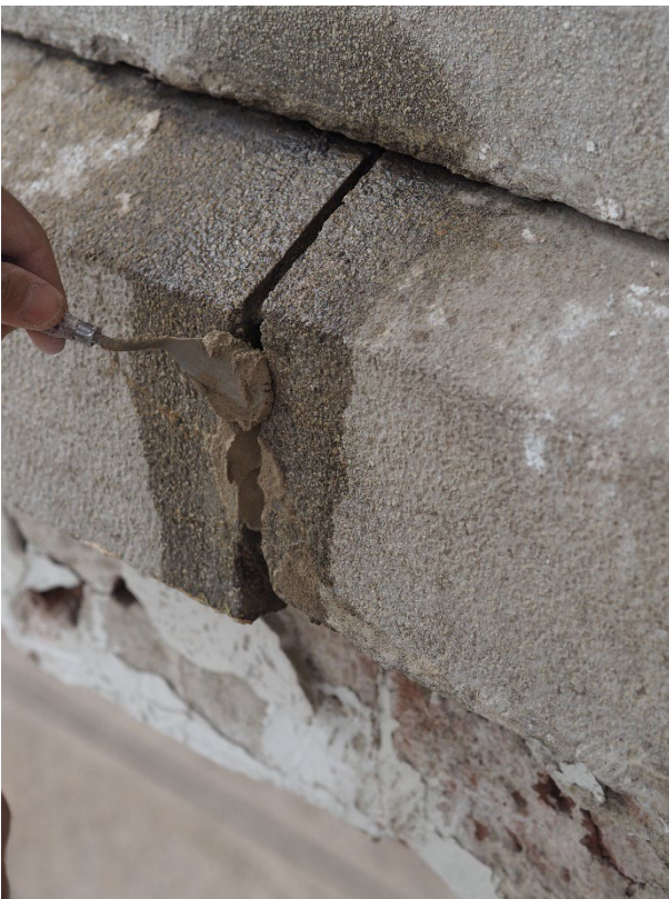
Fig. 4. Timișoara, Palatul István Nemes (1902): chituirea cu ciment Parker a rosturilor dintre blocurile din similipiatră de la baza balustradei balconului (Foto: R. Sacaliș, 2023).
